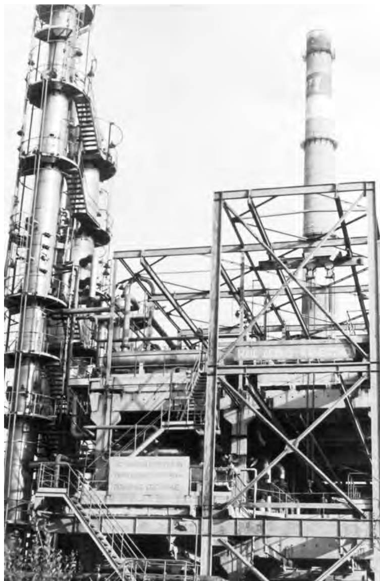
● Установка каталитического риформинга ЛЧ-35-11/600. 1972 год
